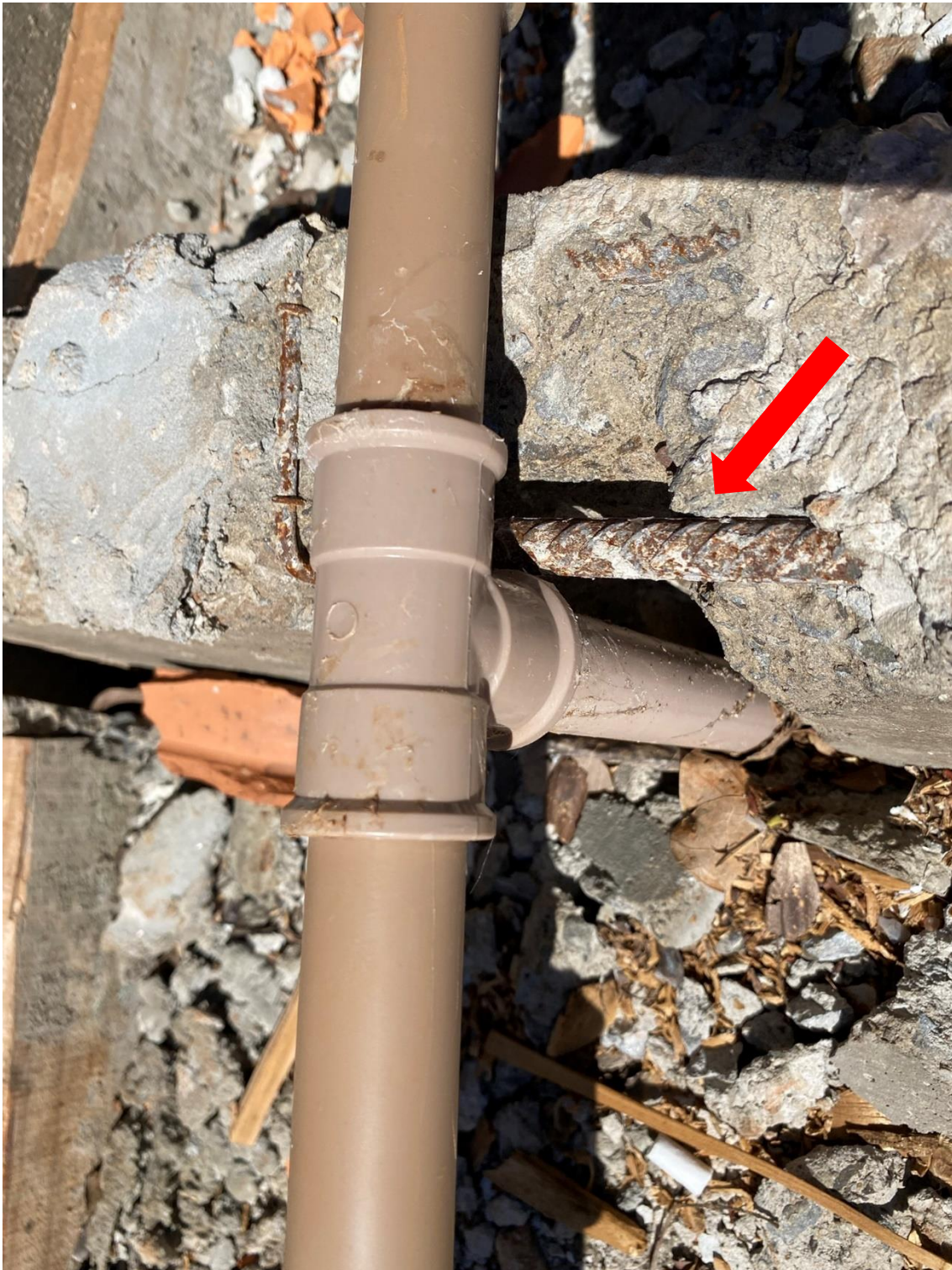
Figura 41 - Vista de tubulação atravessando viga sem previsão, reduzindo a seção do concreto em grande parte. Armaduras expostas e com corrosão.
