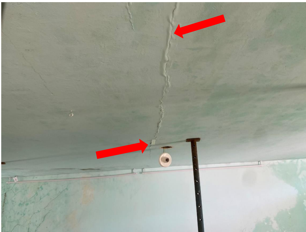
Figura 12 – Outra vista do prolongamento da trinca.
