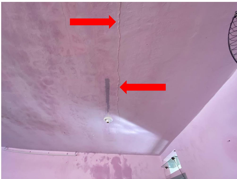
Figura 29 – Vista de trinca longitudinal na laje da sala dos fundos.
