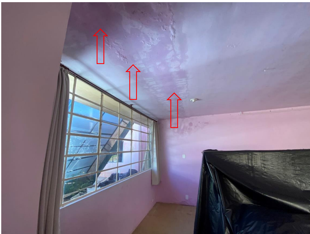
Figura 23 – Vista da umidade acentuada na laje. Detalhe superior de água acumulada nas figuras 59 e 60.
