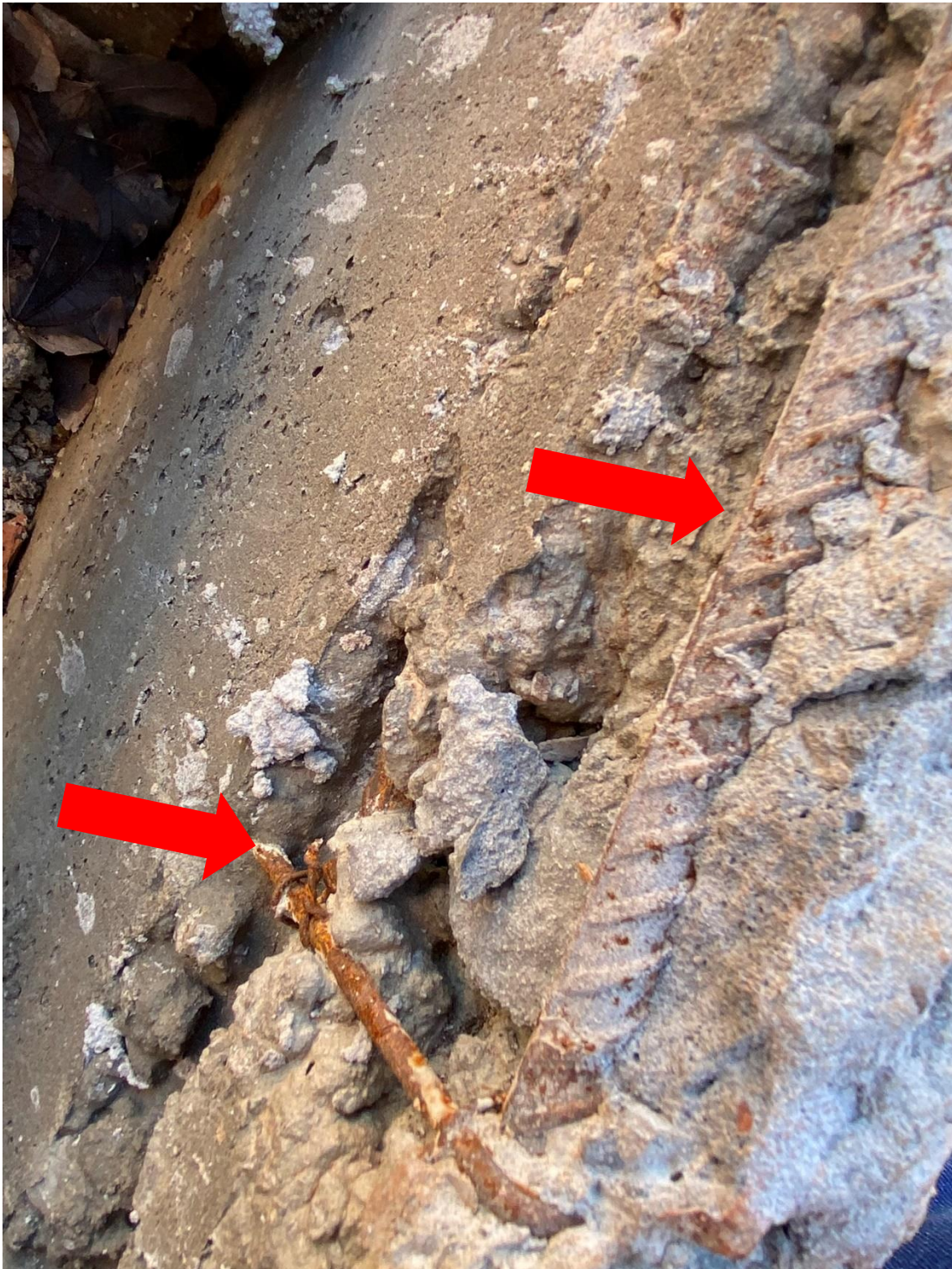
Figura 48 - Armadura e estribos em corrosão, sem revestimento adequado.
