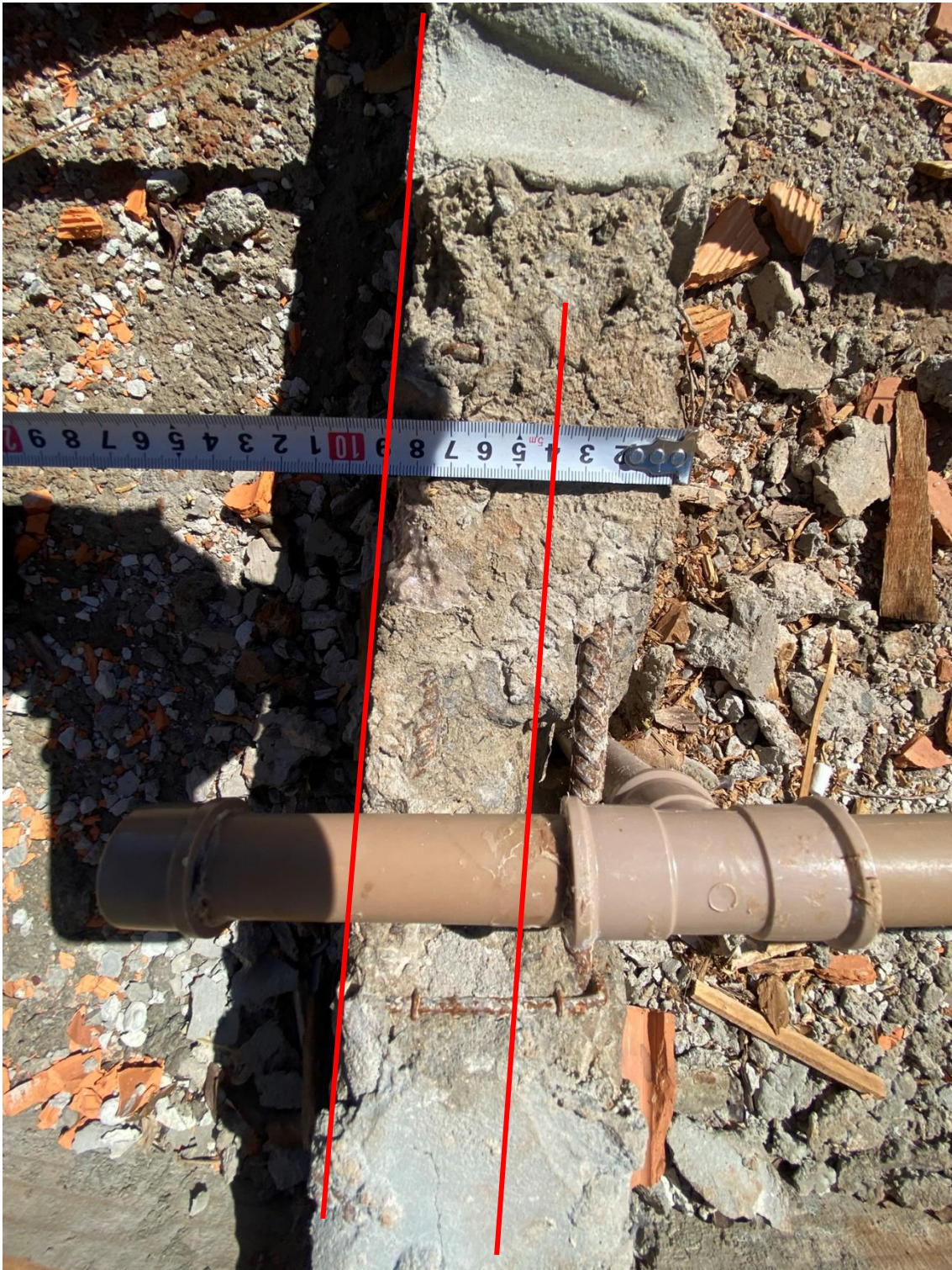
Figura 42 - Dimensão da seção da viga em zona afetada. Viga com dimensão aproximada de 9,0 centímetros de largura, com redução para 4,5centímetros de largura.
