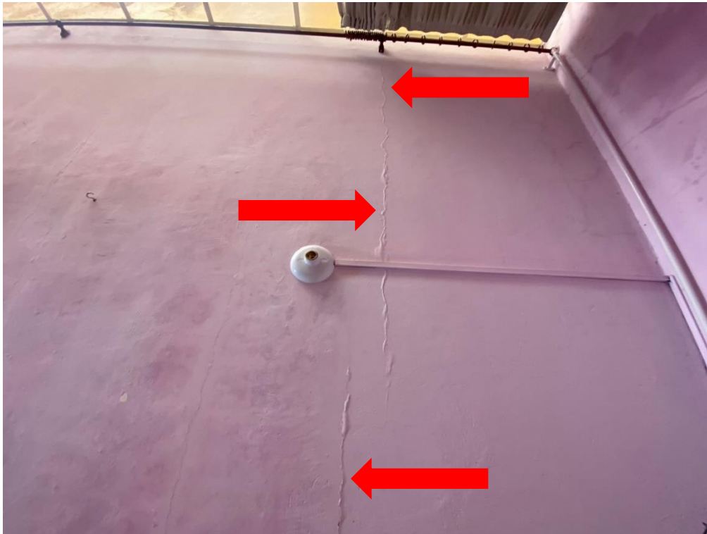
Figura 30 – Vista da trinca longitudinal na laje da sala dos fundos, detalhando a vigota pré-moldada, idêntica a característica das Figuras 9 a 11.
