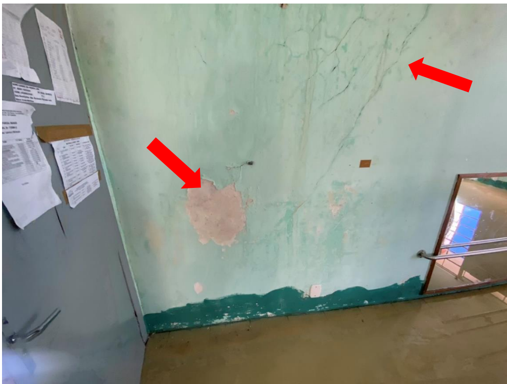
Figura 16 – Fissuras e umidade junto a alvenaria de vedação próximo a porta.
