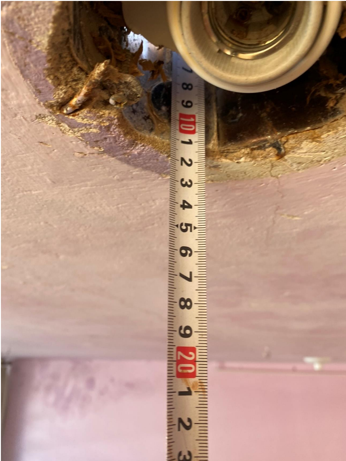
Figura 25 – Visualização da dimensão da laje para o ponto do bocal da lâmpada, aproximadamente 11,5 centímetros;
