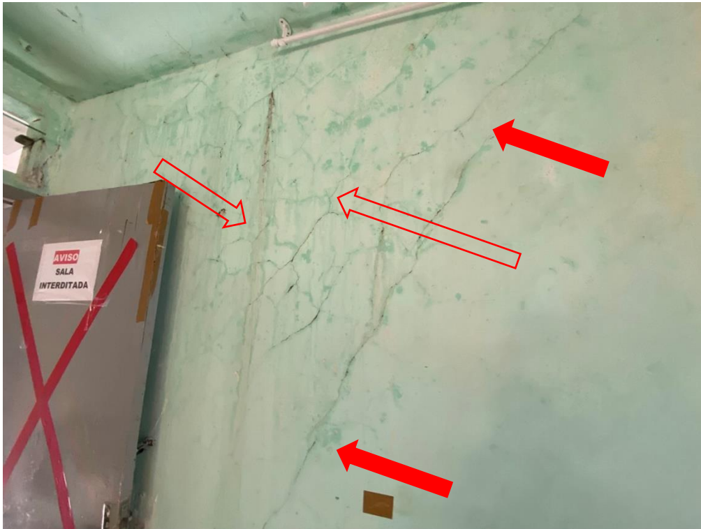
Figura 15 – Fissuras junto a alvenaria de vedação próximo a porta.
