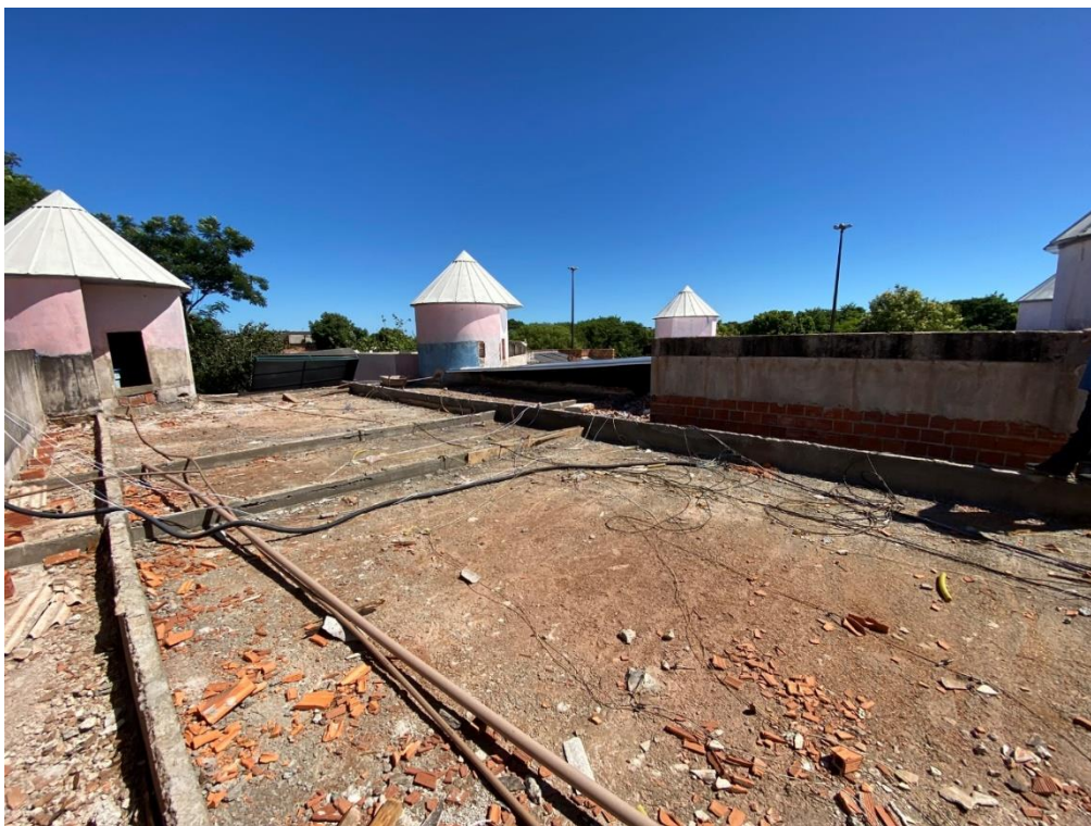
Figura 53 - Vista da laje de cobertura. Detalhe instalação hidráulica sem nivelamento/travamento junto ao piso.
