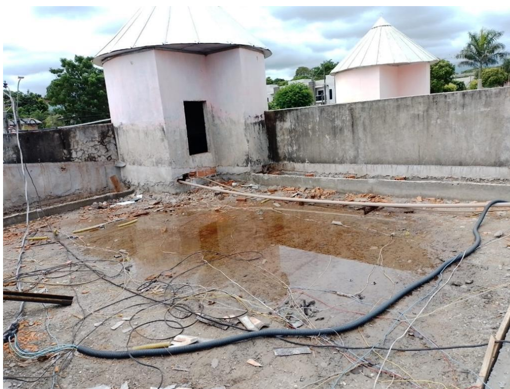
Figura 62 - Acúmulo de água em laje.
