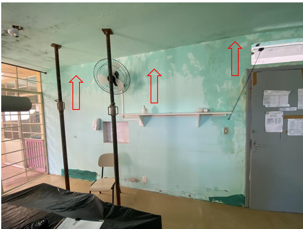
Figura 18 – Detalhe da umidade em alvenaria de vedação próxima a laje.
