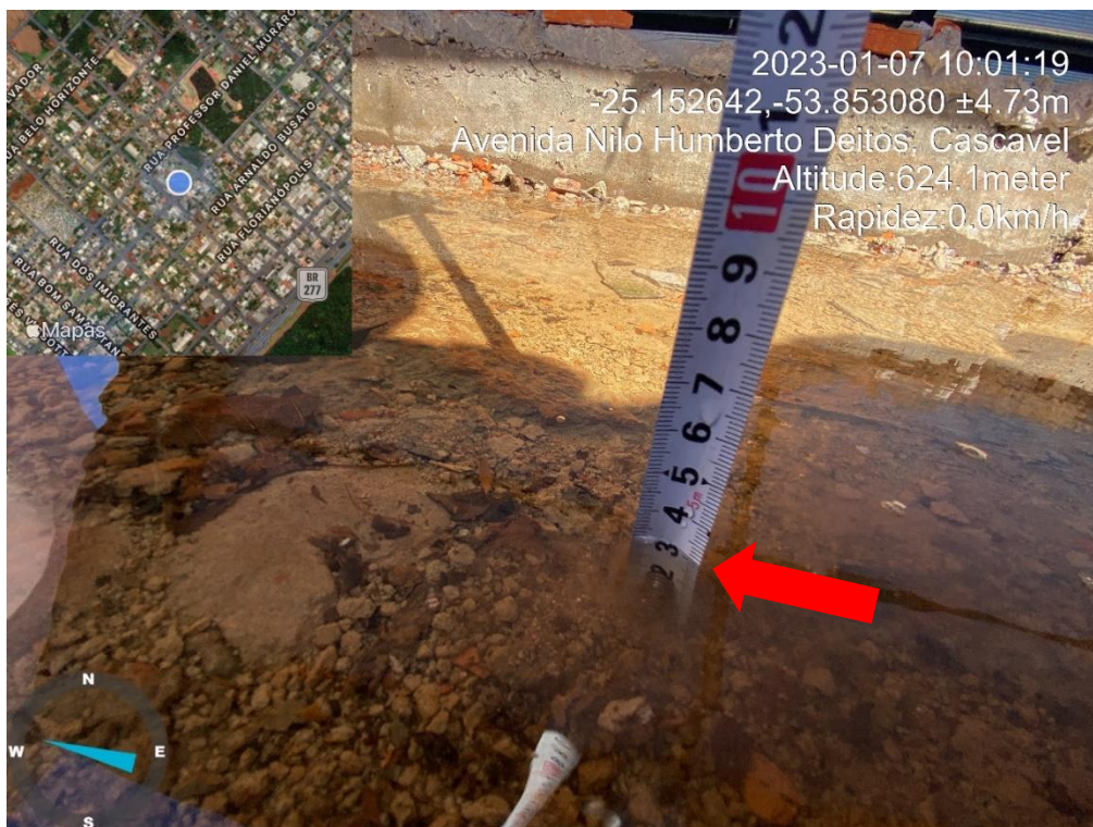
Figura 59 - Acúmulo de água em laje. Aproximadamente 3,0 centímetros.
