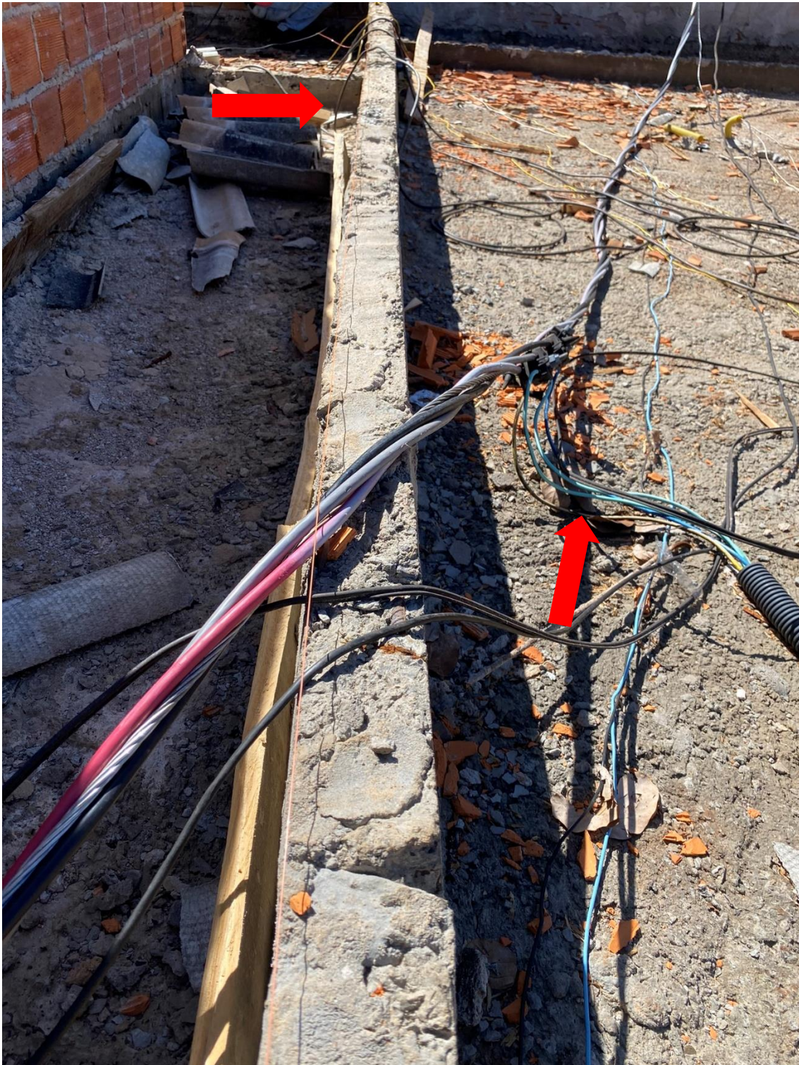
Figura 46 - Detalhe de outra viga em desaprumo (torcida por falha na execução) e fiação elétrica exposta.
