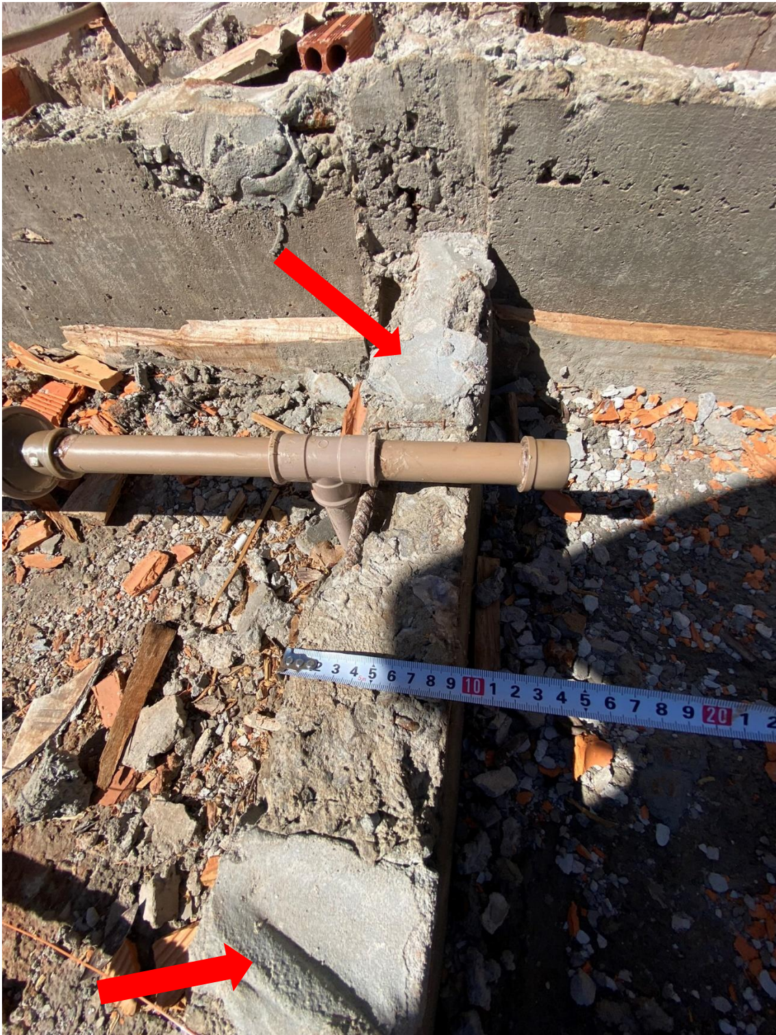
Figura 43 – Vista da viga, detalhes de argamassa para correção/vedação das armaduras.
