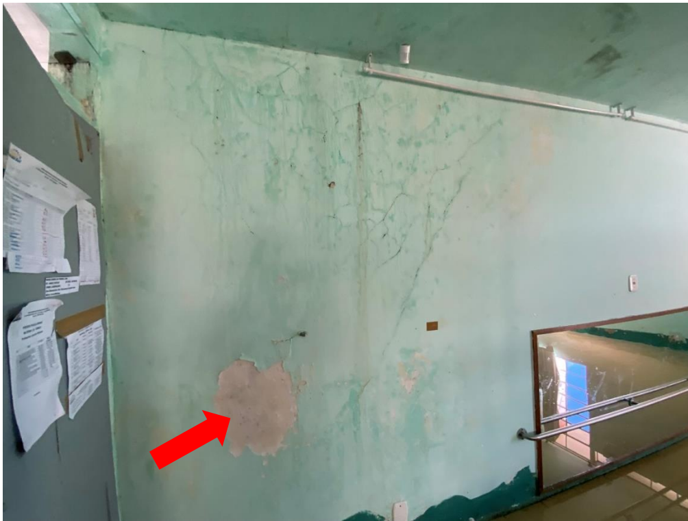
Figura 17 – Detalhe para destacamento do revestimento devido a umidade.
