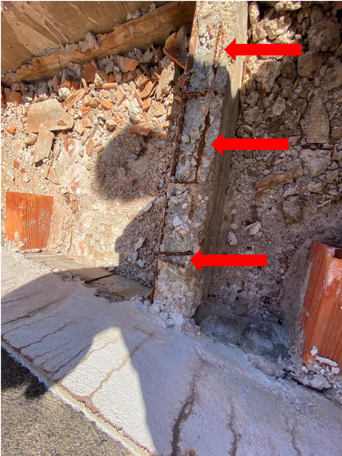
Figura 33 - Detalhe de falha de concretagem em viga.
