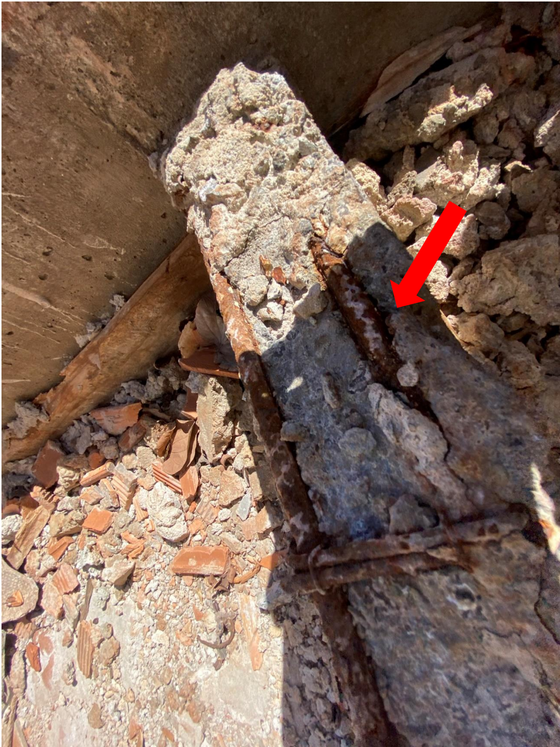
Figura 35 – Detalhe ampliado de armadura com corrosão criando expansão do concreto e seu deslocamento.
