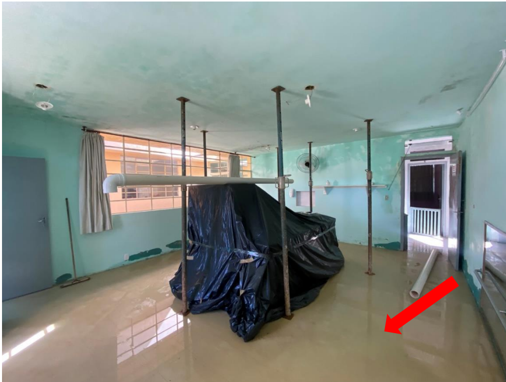
Figura 13 – Sala frontal, detalhe para água acumulada no piso.
