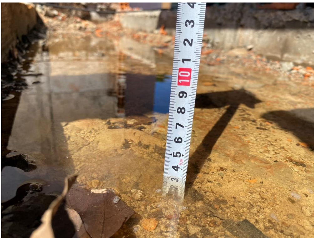
Figura 60 - Vista da medição do acúmulo de água em laje dos fundos.
