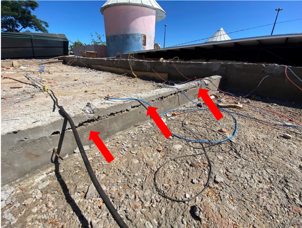
Figura 44 – Vista da extensão da falha de concretagem na viga.
