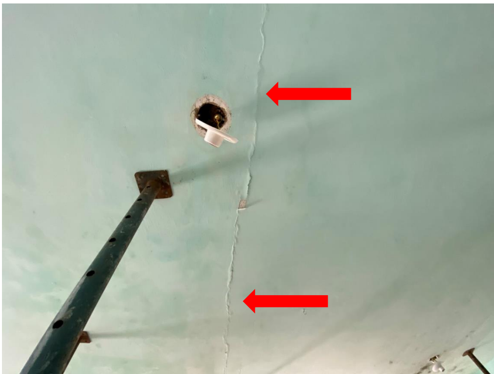
Figura 14 – Detalhe da trinca.
