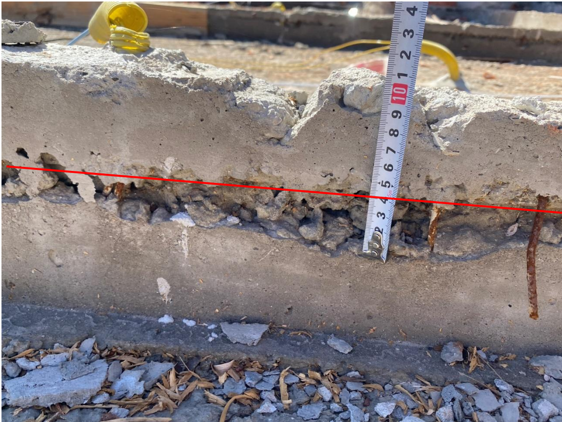
Figura 40 – Vista de nicho de concretagem, dimensão aproximada de 4,5 centímetros (cm). Detalhe do estribo exposto com corrosão.
