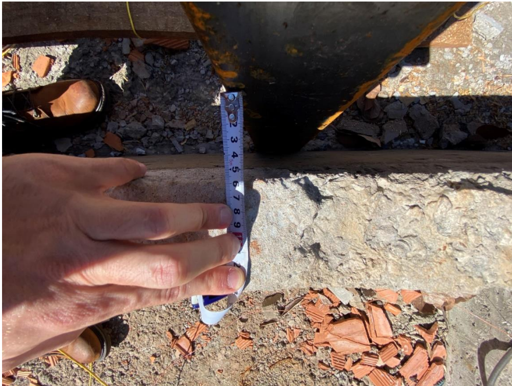
Figura 52 - Medição com auxílio de material plano e nivelado do desaprumo horizontal de viga. Medida aproximada de 5,1 centímetros (cm).
