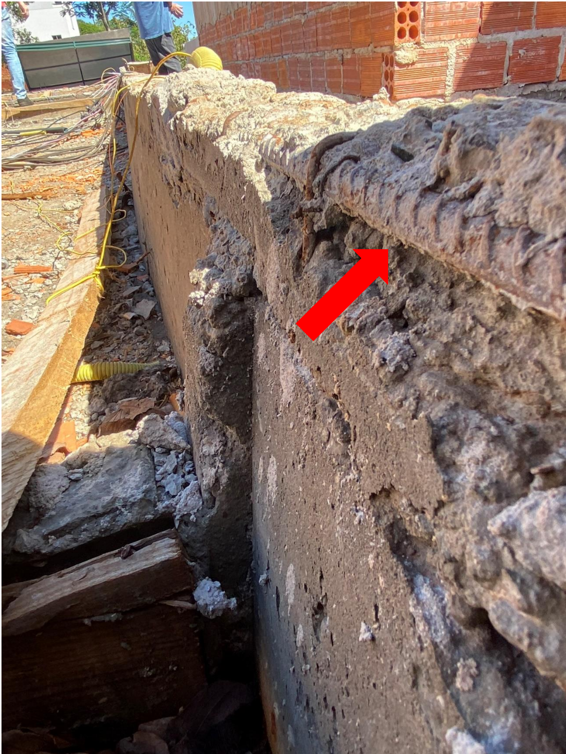
Figura 49 - Vista da diferença de prumo em viga. Detalhe de armadura exposta.
