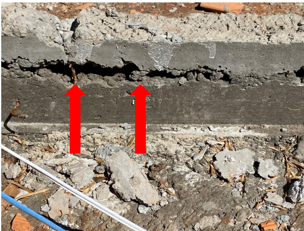
Figura 37 - Vista de nicho de concretagem em viga com estribo exposto e com corrosão.
