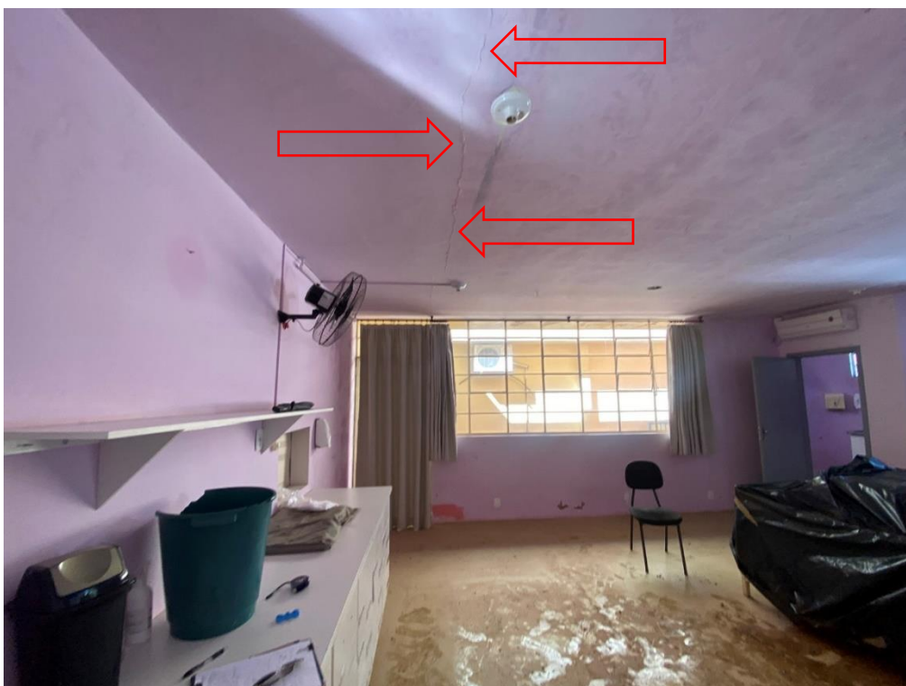
Figura 31 – Vista da localização da trinca na sala dos fundos.
