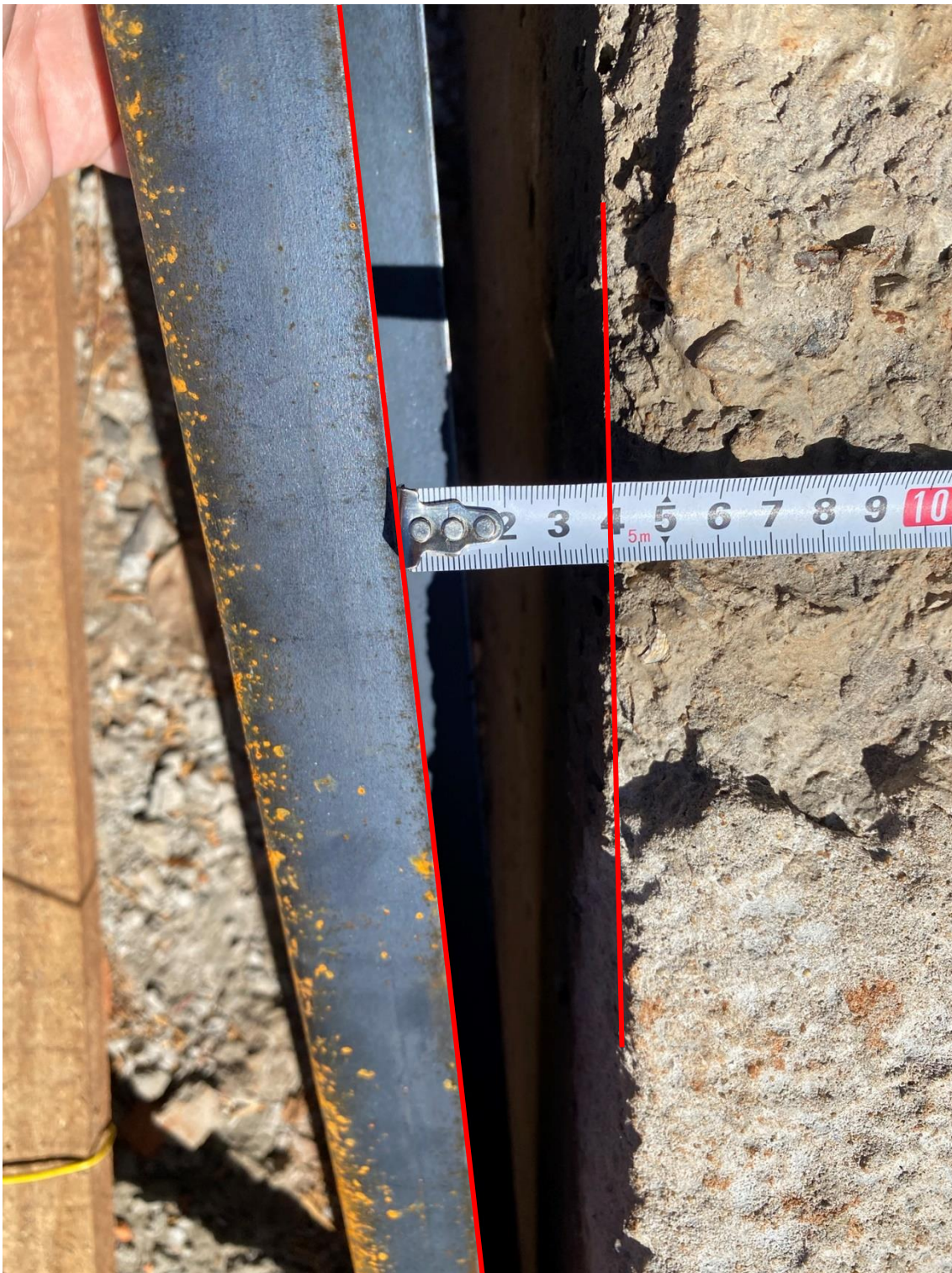
Figura 51 - Medição com auxílio de material plano e nivelado do desaprumo vertical de viga. Medida aproximada de 4,0 centímetros (cm).
