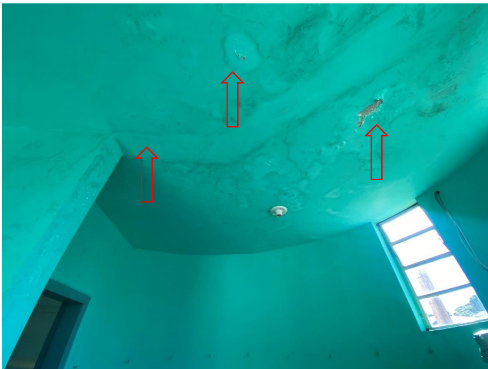
Figura 20 – Detalhe do recorte junto a laje e da existência de umidade.
