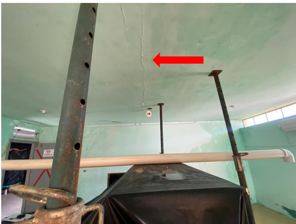
Figura 10 – Vista da extensão da trinca em laje.
